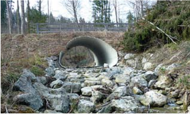
Vor der Maßnahme war zumindest bei niedriger Wasserführung keine Durchgängigkeit über die Rampe gegeben Foto: Claire Tranter
