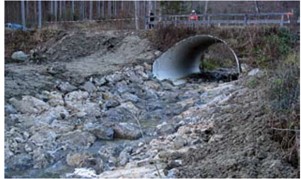
Nach der Maßnahme: die gestaltete Niedrigwasserrinne ermöglicht die Durchgängigkeit in den Kohlgraben hinein Foto: H.P. Schöler, BaySF
