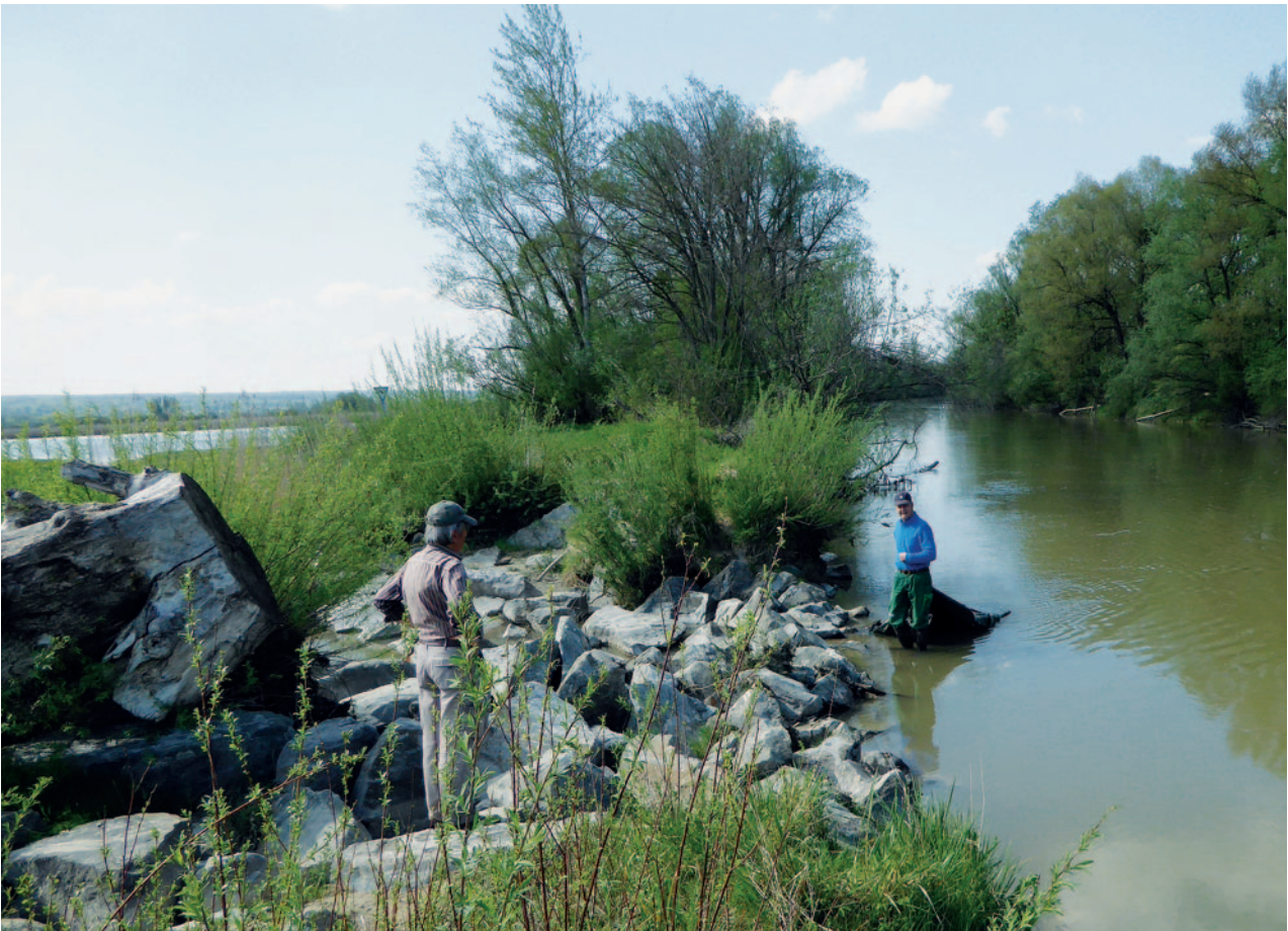
Bruchstelle am Westdamm der Neuen Ammer, Foto: Helene Falk
